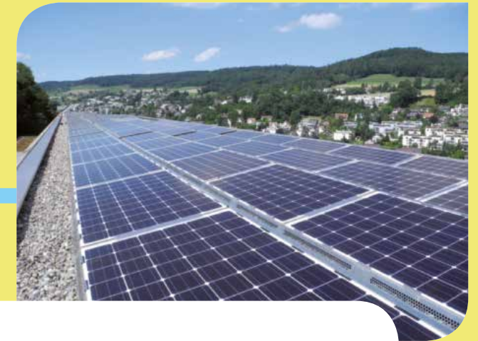
Fertige Solaranlage auf dem Schulhaus Bruggerstrasse
